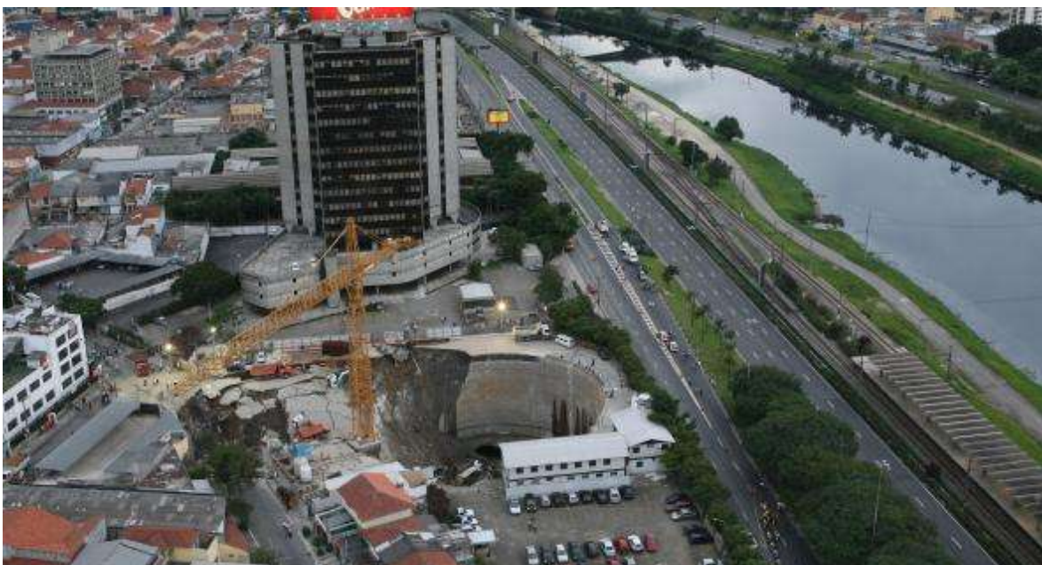
Registro no ponto do acidente, após o ocorrido, em 12/Janeiro/2007
