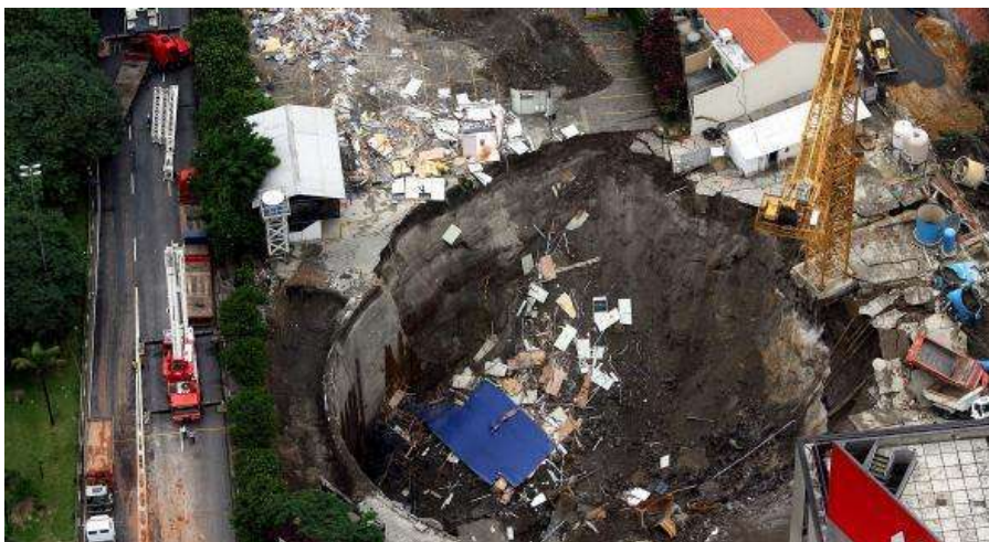
A foto mostra uma visão superior da escavação, onde se pode perceber a área instável (contorno) que se movimentou, levando máquinas, equipamento e pessoas para baixo
